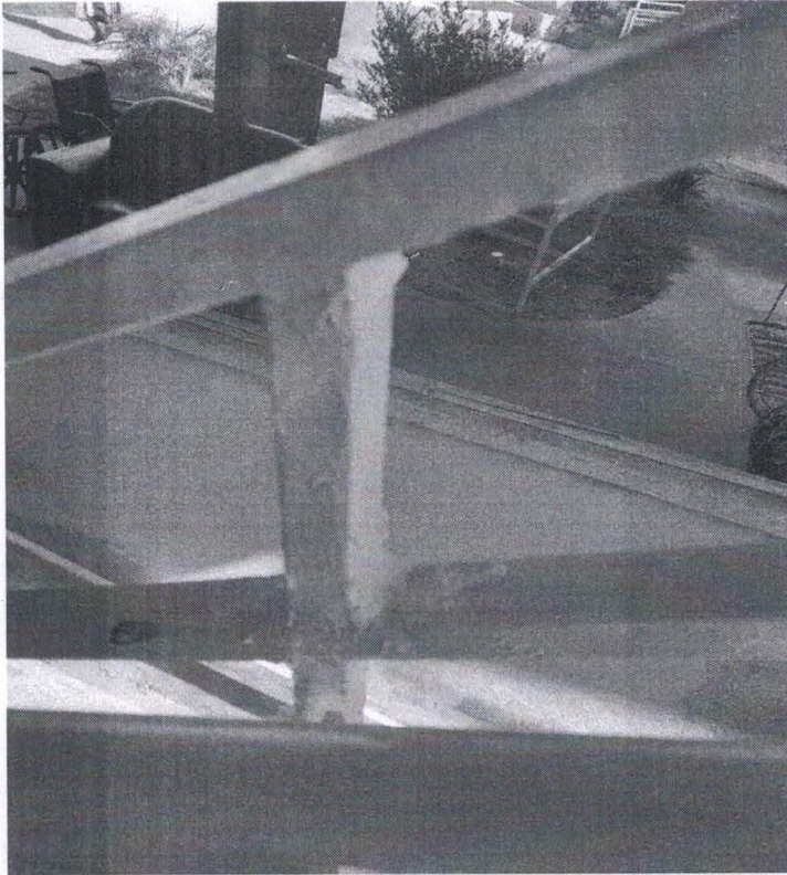
Guarda-Corpo e Corrimão, que dão acesso ao segundo andar – Sala de Reunião e Vestiários
